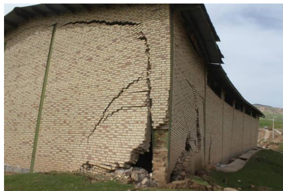
تخریب و شکست سوله ورزشی روستای حسین‌آباد
